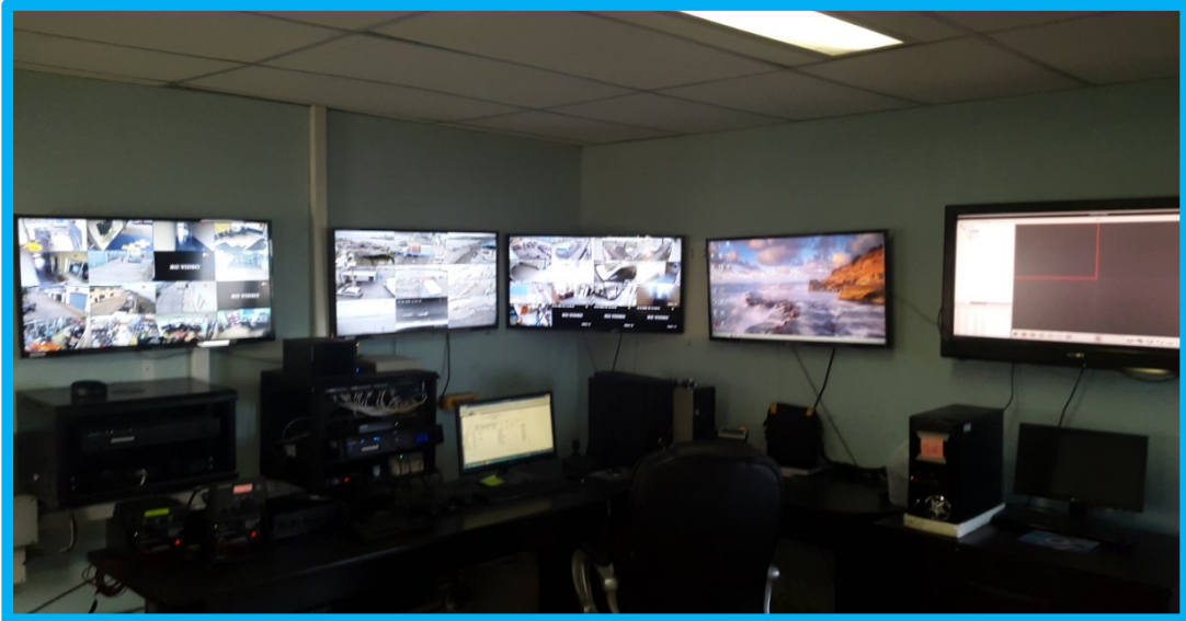
Sala de Control del Circuito Cerrado CCTV
